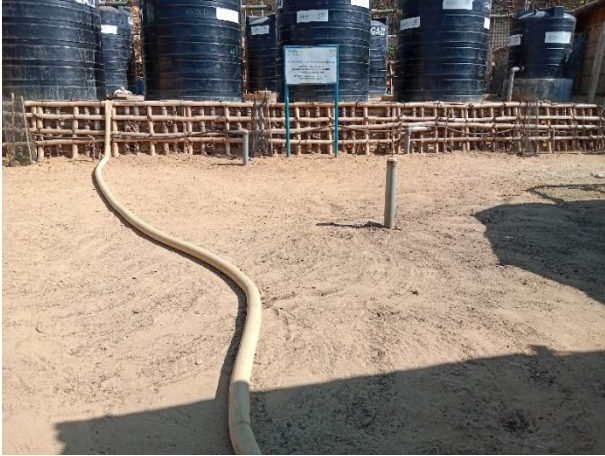
Infiltration (FE) beds
